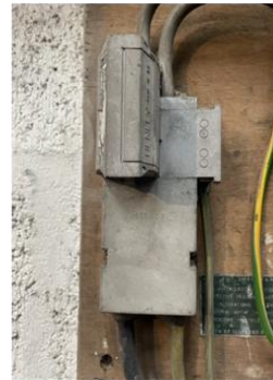
100-amp site fuse
